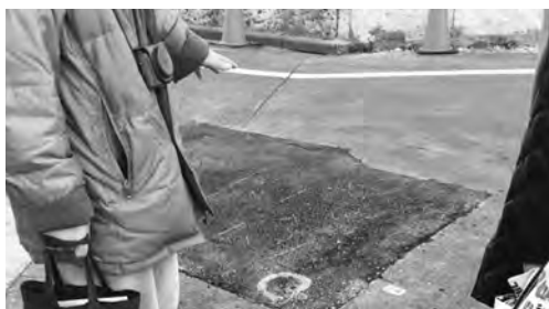
ガスが漏れた跡。Gの文字が見える。ボーリングの跡やずれやへこみの修理で道路はつぎはぎだらけだ。
